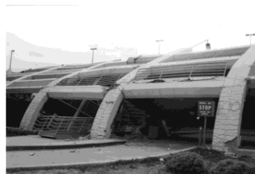
Gambar 1.1 Struktur Bangunan Parkir yang Runtuh Akibat Gempa Northridge Pada Tahun 1994 (Sumber: Erdey, 2007)
