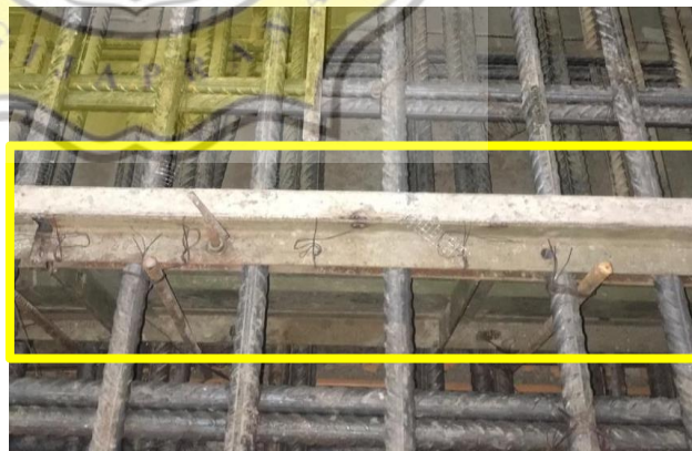
Gambar 3.36. Stop cor Sumber: Dokumentasi Pribadi, 2019
