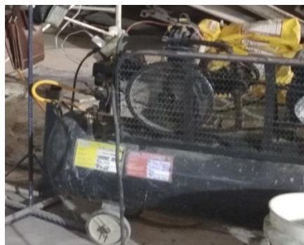
Gambar 3.92. Air Compressor Sumber: Dokumentasi Pribadi, 2019
