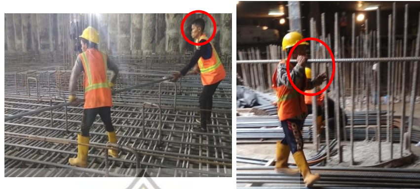
Gambar 3.127. Pekerja tanpa APD Sumber: Dokumentasi Pribadi, 2019
