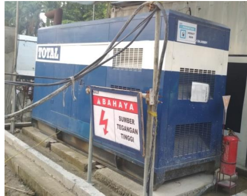
Gambar 3.87. Generator Set Sumber: Dokumentasi Pribadi, 2019
