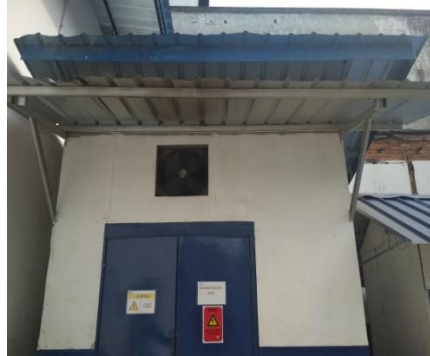
Gambar 3.8. Rumah Trafo PLN Sumber: Dokumentasi Pribadi, 2019
