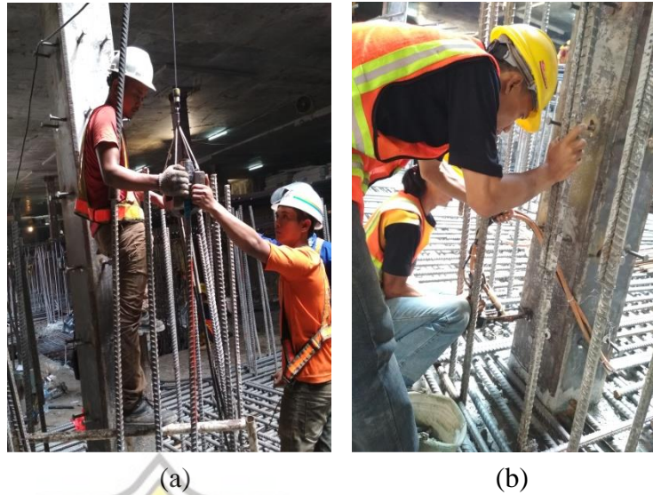
Gambar 3.44(a). Proses Pemasangan Coupler Gambar 3.44(b). Proses Pemasangan Shear Stud Sumber: Dokumentasi Pribadi, 2019
