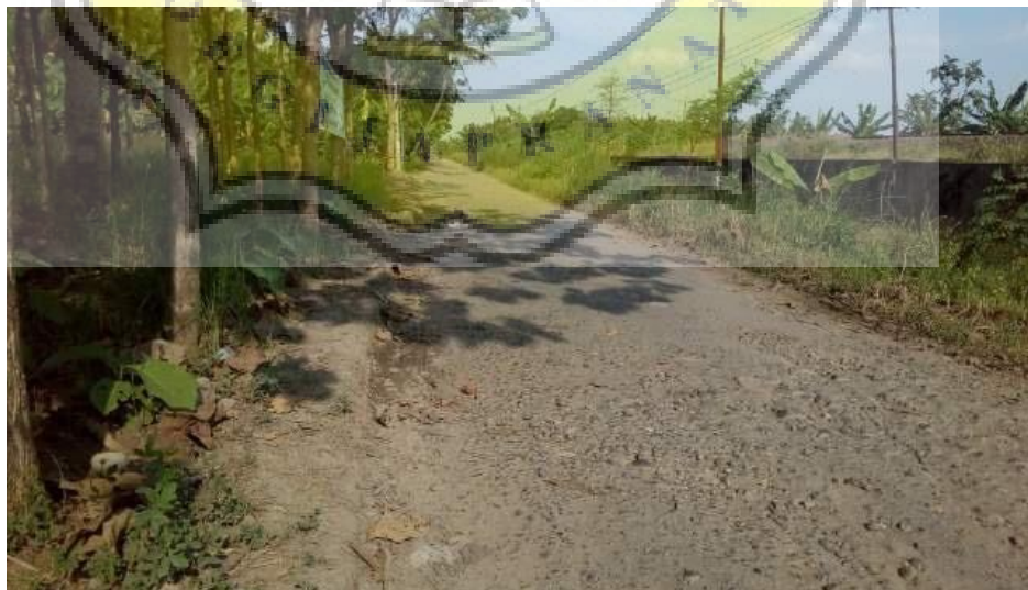
Gambar 1.1 Kondisi jalan bergelombang. Jalan Gedangan Raya, Genuk, Semarang
