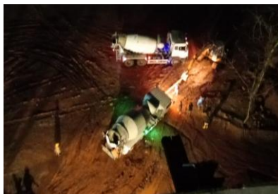
Gambar 4.18 Kondisi Truck Mixer Terperosok
