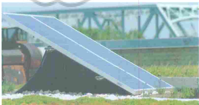
Gambar 4.28 panel surya pada atap dack beton bertanaman. Sumber gambar : www.greenrooftechnology.com
