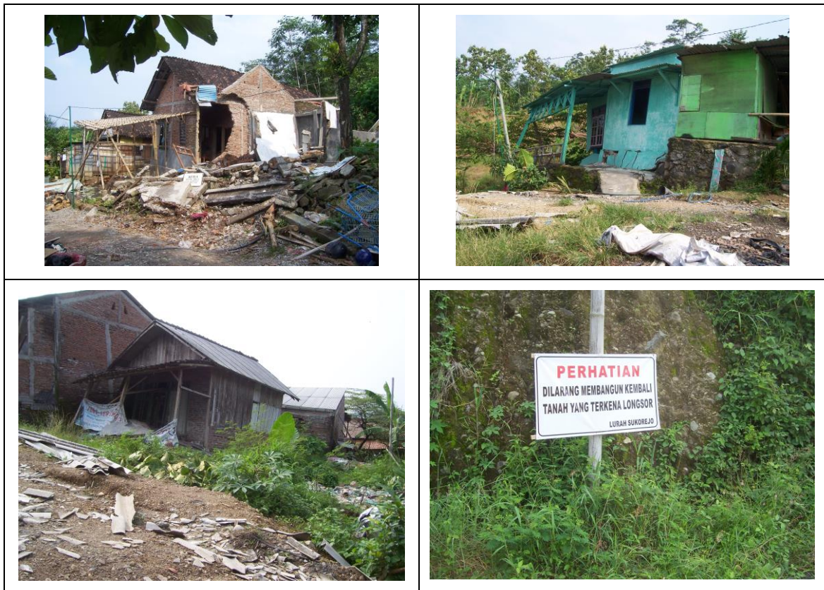
Gambar 4: Kerusakan Rumah Warga di Trangkil dan Tanda Peringatan
