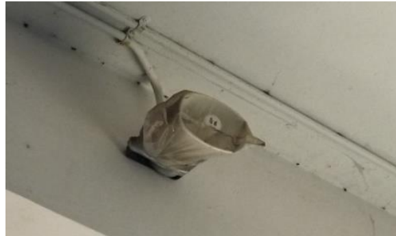
Gambar 4.46 Speaker Pada Gedung Parkir Pandanaran
