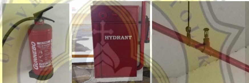
Gambar 4.47 Fasilitas Pemadam Kebakaran
