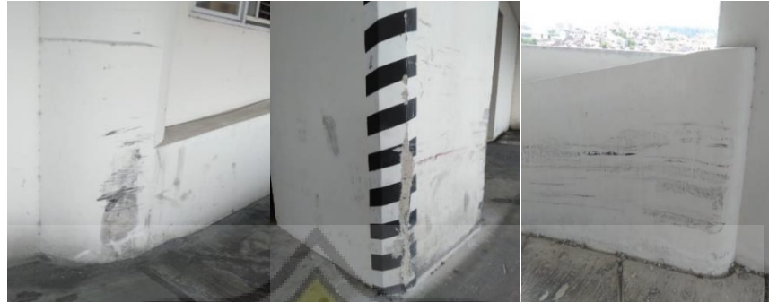
Gambar 4.54 Kerusakan Pada Tikungan Gedung Parkir
