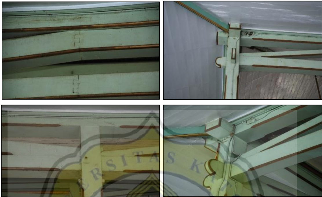
GAMBAR 4.32 Bagian balok-balok yang mengalami kerusakan
