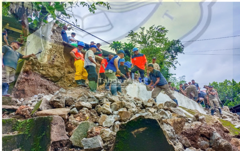
Gambar 4.3 BPBD Lakukan Pembersihan Material Longsor Sumber: Hasil tangkapan layar website Pemerintah Kota Ambon
