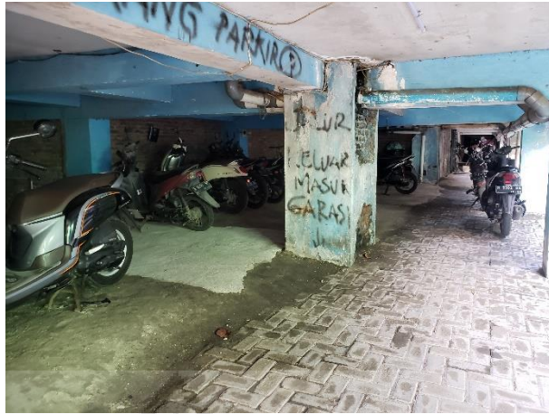
Gambar. 18 Kondisi Basemen Parkir Blok Tengah Akibat Penurunan Tanah Di Blok tengah
