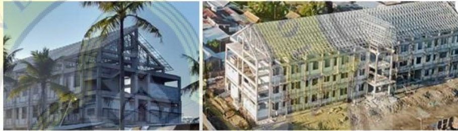
Gambar 2.3.3.2 Rusun Bintaro Ampenan Tanpa Penutup Dinding Sumber: ( Proyek Pembangunan Rusunawa Di NTB Ditargetkan Selesai Pada November 2021 - Bisnis.Com , n.d.)
