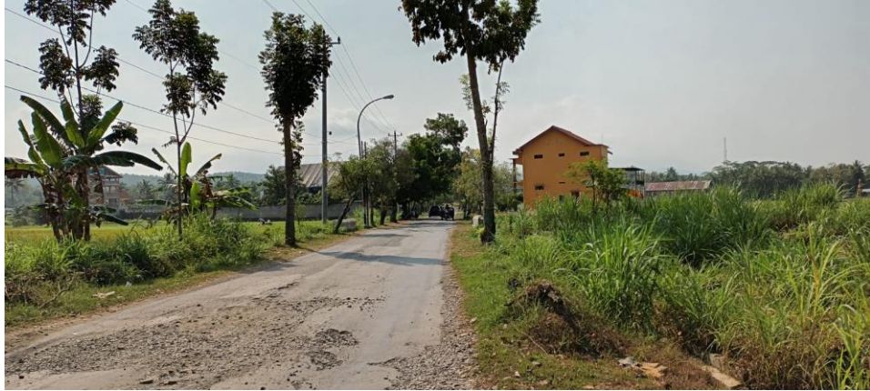
Gambar 22. Suasana Jalan Sanun yang Rusak Sumber : Data Pribadi
