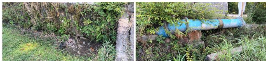
Gambar 19. Utilitas Air Bersih Jalan Sanun Sumber : Data Pribadi
