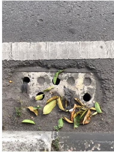
Gambar 3.10 Drainase pada Jalan Hos Cokroaminoto
