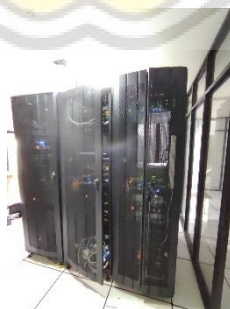
Gambar 17 Rak Server dan Area Telekomunikasi Pusat Data Dinas Kominfo Kota Semarang. (Sumber: Dokumentasi Pribadi 24-12-2021)
