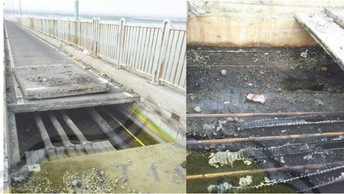
Gambar 51 Saluran Instalasi Listrik pada Jembatan
