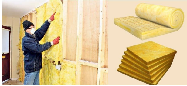
Gambar 6.12 Penggunaan material glass wool pada dinding
