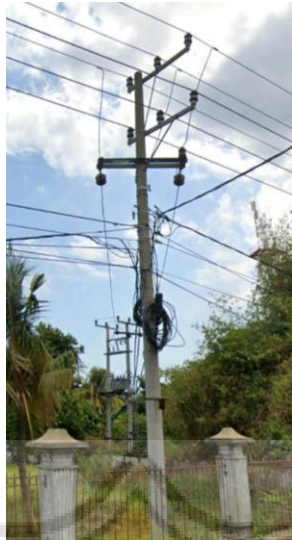
Gambar 80. Posisi Tiang Listrik sumber : Dokumentasi Pribadi
