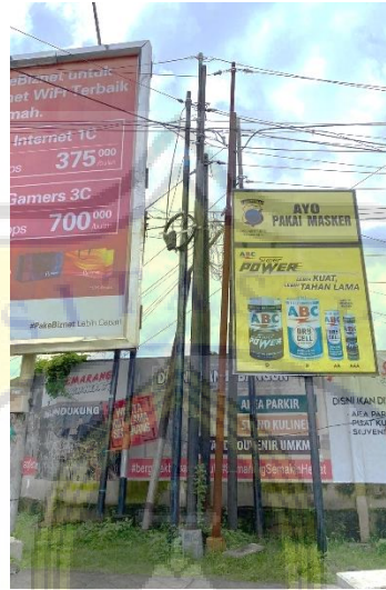
Gambar 3.23. Jaringan Listrik Pada Depan Tapak
