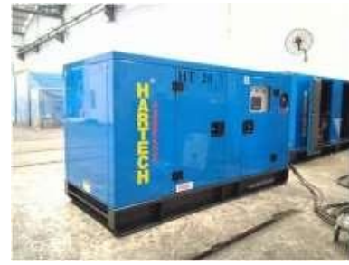
sumber cadangan, genset
