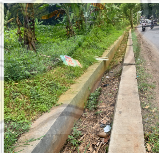
Gambar 105 Drainase Sumber : (Dokumentasi Pribadi)
