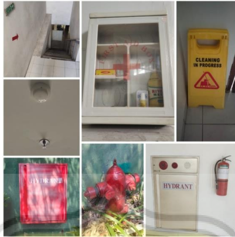
Gambar 4.3.9. 1 Fasilitas Keselamatan Hotel Dafam Semarang
