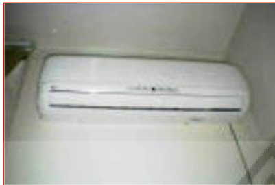
Gbr 41. Air Conditioner Sumber: Konsep PTSB VI
