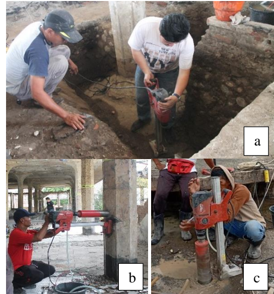
Gambar 17. Pelaksanaan core drill , a) Pondasi, b) Kolom, c) Pelat lantai. (Sumber: Penulis, 2017)
