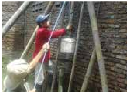
4. PEMASANGAN CERUCUK BAMBU DENGAN SEBAGAI LANDASAN PONDASI. CERUCUK BAMBU DIMASUKKAN KE TANAH DENGAN BANTUAN PILE HAMMER
