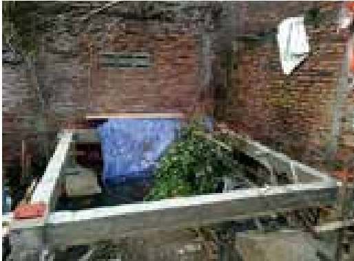
9. SLOOF DIGUNAKAN SEBAGAI PENGIKAT BANGUNAN OMPALIS DAN PLAT LANDASAN TEMPAT PELETAKAN KOLOM.
