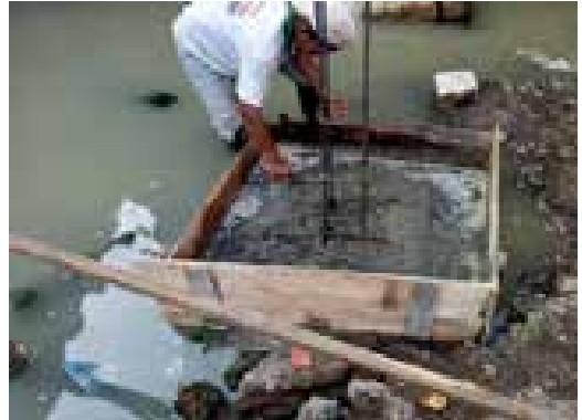
6. PENGEORAN PONDASI FOOTPLAT DENGAN AIR PAYAU (PENGEORAN DENGAN AIR BERSIH AKAN MENGHASILKAN BETON BERKUALITAS LEBIH BAIK).
