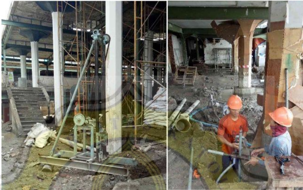
Gambar 4.85. a) Alat bor untuk lokasi kolom pada void, b) Pengeboran manual pada kolom bawah mezanin. Sumber: Sriwati Purnomo, 2018
