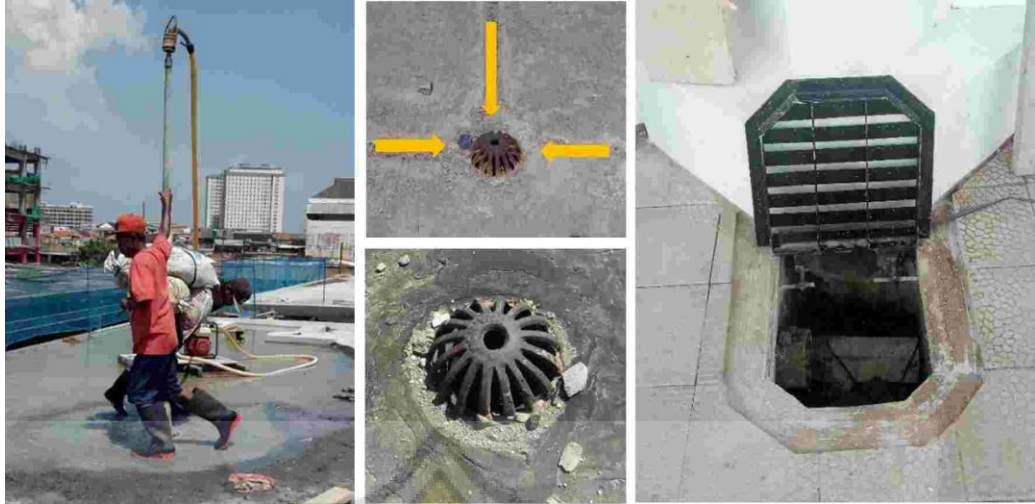
Gambar 4.55. a) Perbaikan torong dengan wash boring manual, b) Penutup torong pada atap, c) Penutup torong pada atap, d) Bak kontrol pada bagian bawah kolom.
