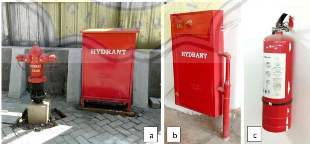
Gambar 4.59. a) Hydrant pilar dan hydrant box di luar bangunan, b) Hydrant box di dalam bangunan, c) APAR di dalam bangunan. Sumber: Sriwati Purnomo, 2019
