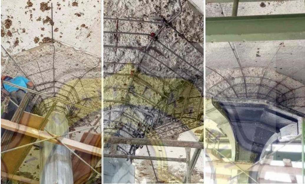
Gambar 4.77. a)Pemasangan tulangan baru pada cendawan, b)Tulangan baru pada cendawan, c) Begisting fiber untuk cendawan. Sumber: Sriwati Purnomo, 2018
