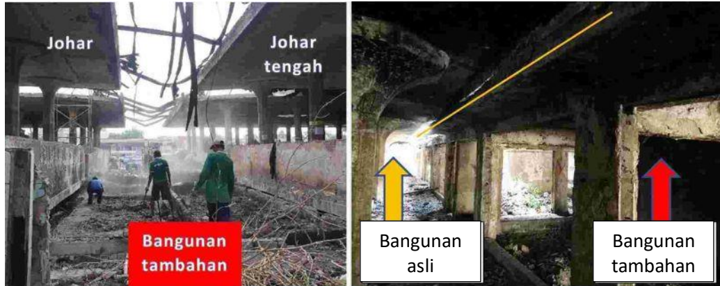
Gambar 4.49. a) Bangunan tambahan diantara Johar Utara dan Johar Tengah (sisi atas), b) Bangunan tambahan diantara Johar Utara dan Johar Tengah (sisi bawah)
