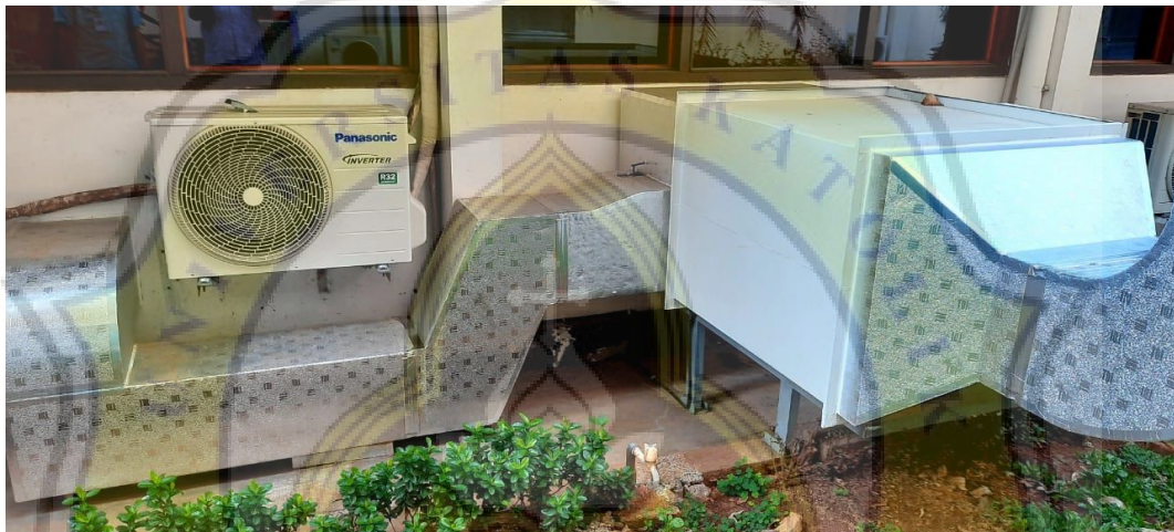
Gambar IV.15 Aliran udara di RIK COVID menggunakan AC dan exhaust fan yang dihubungkan dengan HEPA ducting ke udara bebas Sumber: Survei Lapangan
