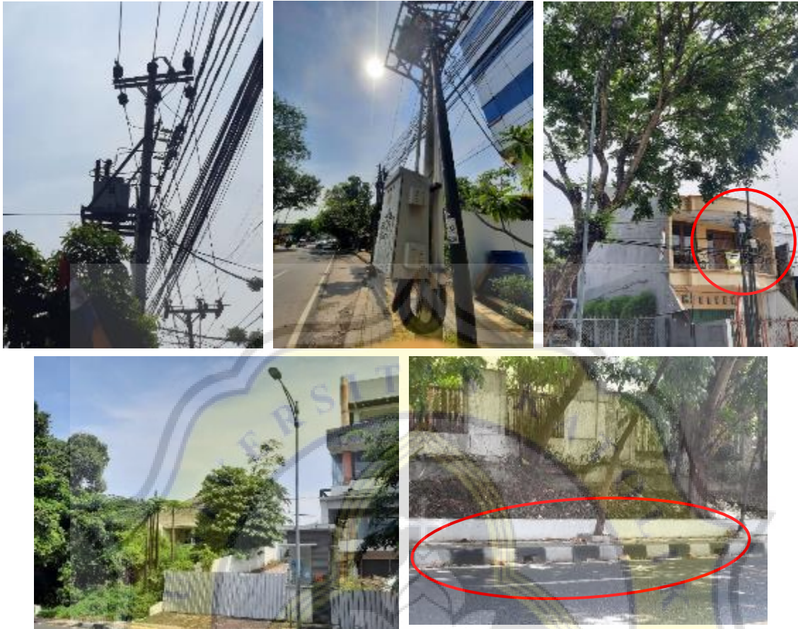
Gambar 3. 71 Jaringan Utilitas dilokasi tapak Sumber: Dokumen Pribadi
