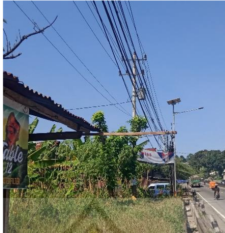
Gambar 3. 37 Trafo Listrik pada Tapak (sumber: dokumentasi pribadi)
