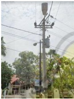
gambar3.3 2 tiang listrik dan penerangan jalan tapak
