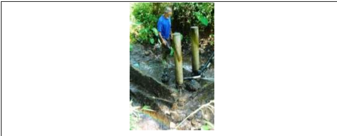
Gambar ... Pompa Hidram dengan klep ganda di Desa Ngemplak, Temanggung Sumber: Rejeki dkk, 2015
