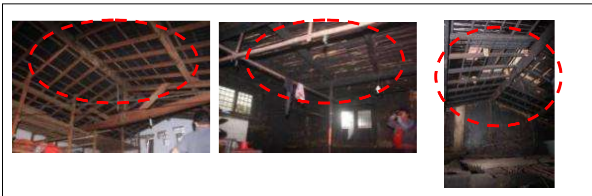
Gb 62: Penggunaan Rangka Atap Berjarak Dekat Dan Penutup Atap Bahan Seng Finishing Cat Warna Hitam Di Lokasi Penelitian
