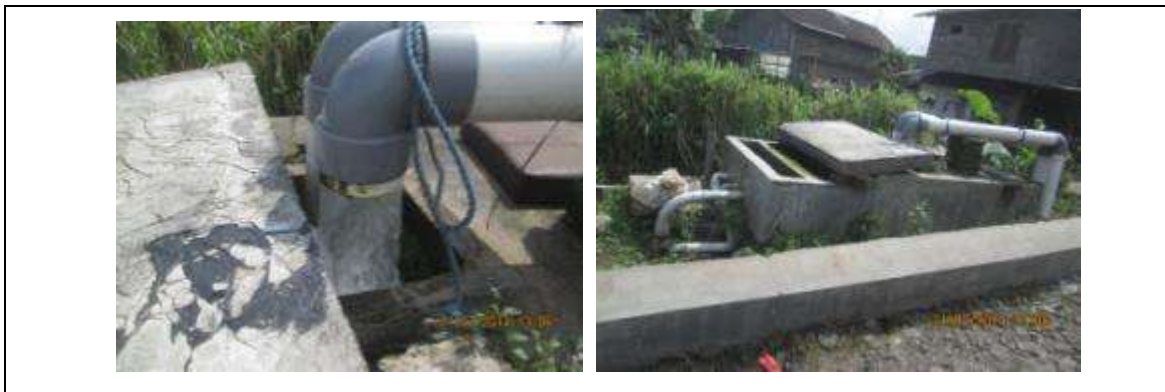
Gb. 70: Sistem Penyaluran Air Ke Rumah Penduduk Sumber: Data Primer, 2014
