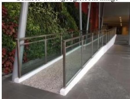
Gambar 50 : Relling Pada area Ramp
