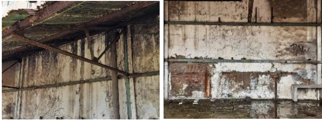
Gambar 54 Dampak Klimatik pada Bangunan Sumber: Dokumentasi Pribadi
