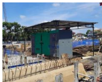
Gambar 4.5 Upaya Penghematan Energi dengan Genset
