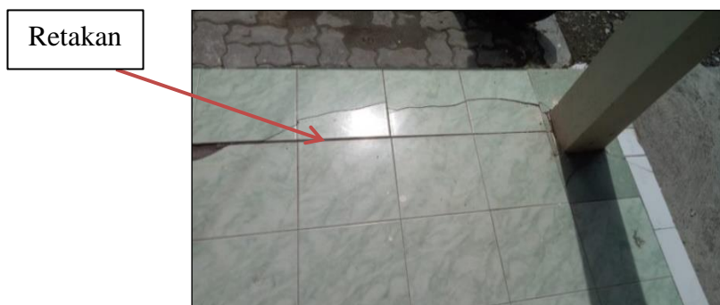
Gambar 1.2 Kerusakan Bangunan Akibat Penurunan Fondasi
