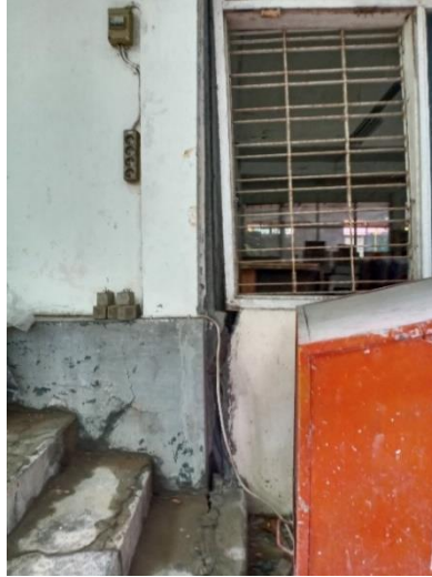
Gambar 11. Dokumentasi kerusakan di Gedung Lab. Teknik.
