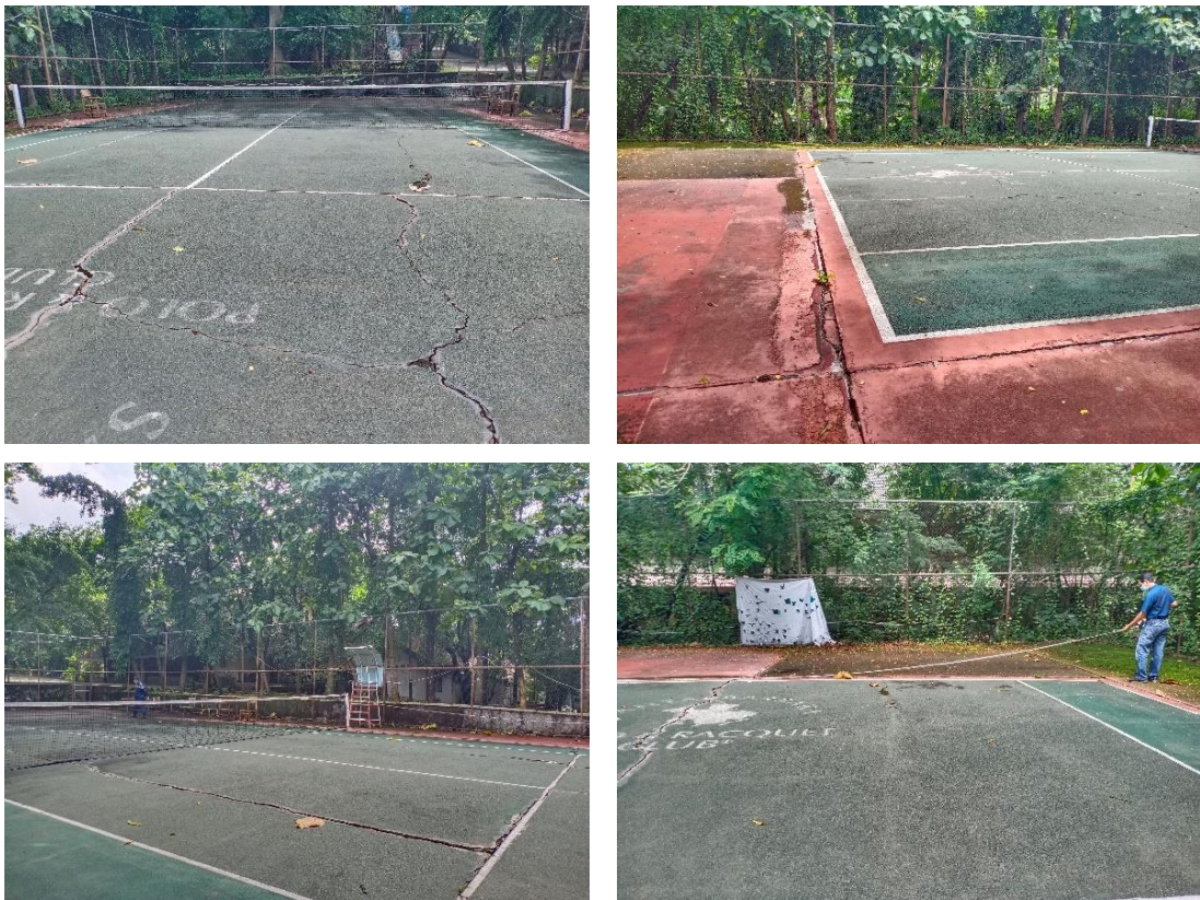
Gambar 17. Dokumentasi kerusakan di Lapangan Tenis.
