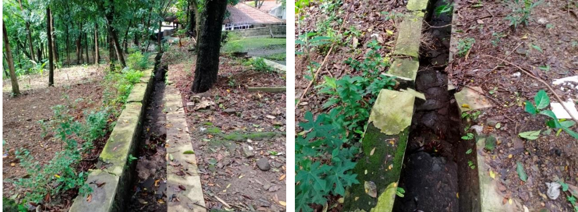
Gambar 13. Dokumentasi kerusakan di Joglo Sanjaja.
