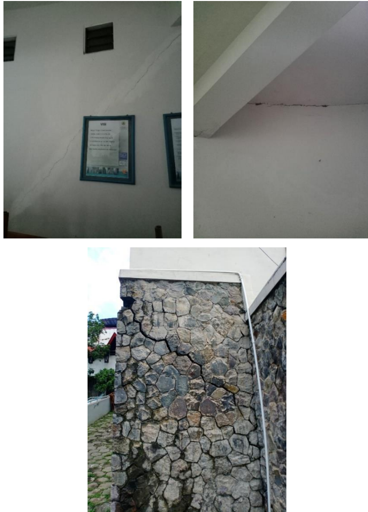
Gambar 21. Dokumentasi kerusakan di HC (A).
