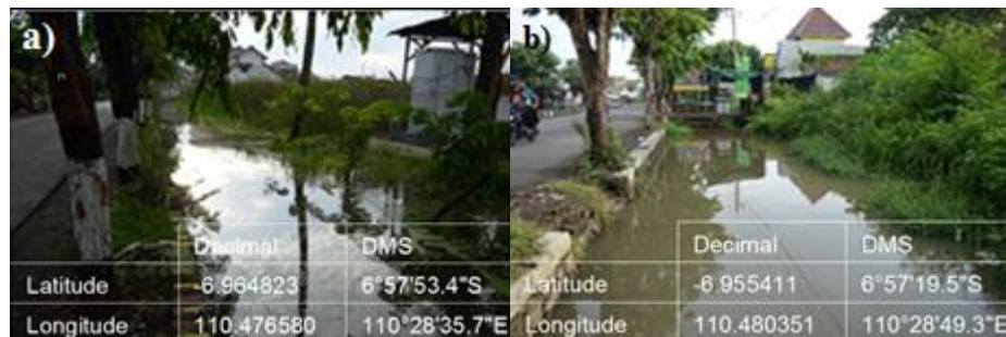
Gambar 4.26 Kondisi Conduit C.10 dan C.20 Setelah Hujan
