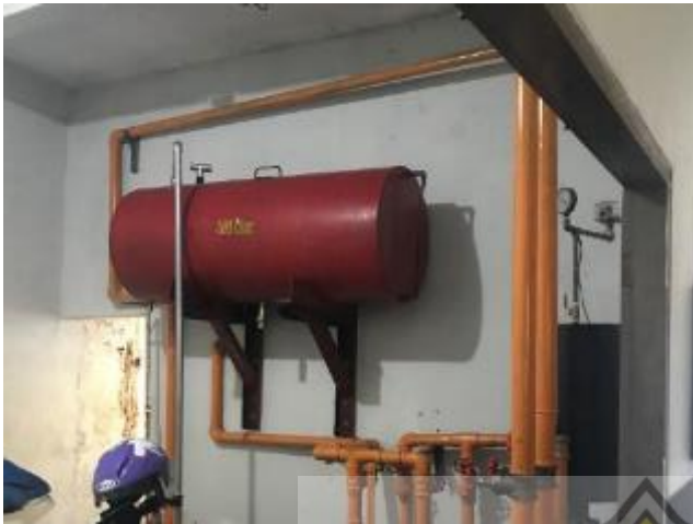
Gamba 6. Tabung Gas untuk Air Panas Sumber: Dokumentasi Pribadi
