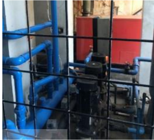
Gambar 7. Pompa Air Hotel Quirin Sumber: Dokumentasi Pribadi
