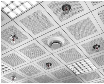
Gambar 7.3 Sprinkler dan Smoke Detector
