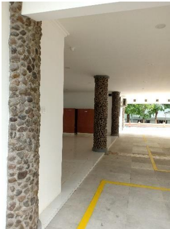
Kondisi- dri Parkir tidak ada penyekat
