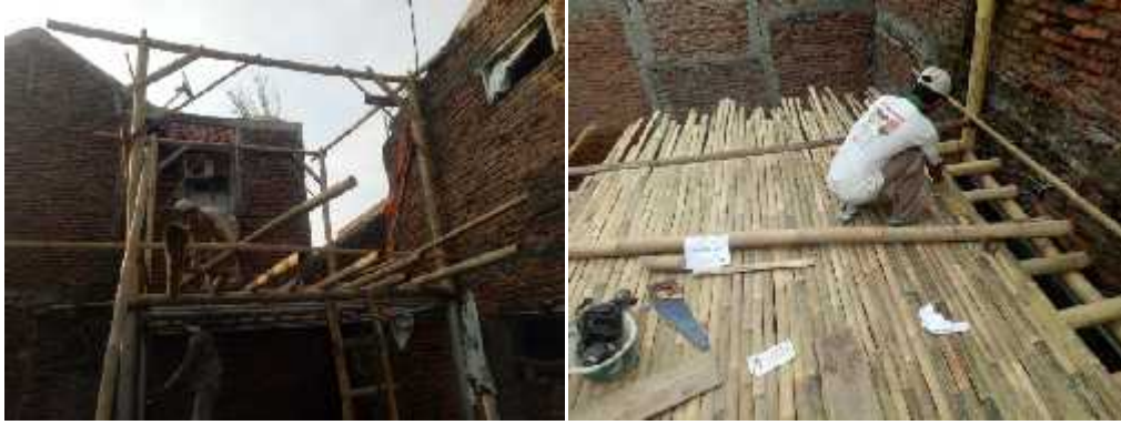
Gambar 5.16: Pemasangan tiang bambu dan lantai rumah bambu dari bilah bambu yang dipasang di atas gelagar bambu
