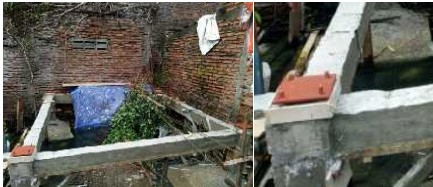
Gambar 5.12: a. Sloof yang digunakan sebagai pengikat bangunan “Rumah Hidrolis” b. Plat landas tiang pipa hidrolis yang dipasang pada 4 titik tumpuan/tiang.
