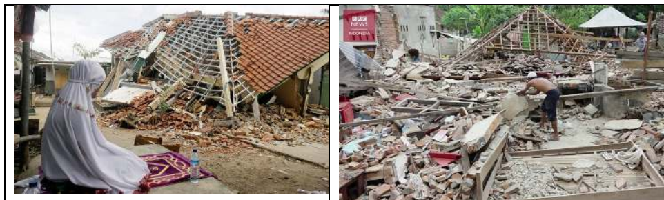
Gambar 10.a: Atap rusak dan turun runtuh tidak bersamaan karena hanya satu sisi tumpuan yang runtuh (Gempa Lombok)
