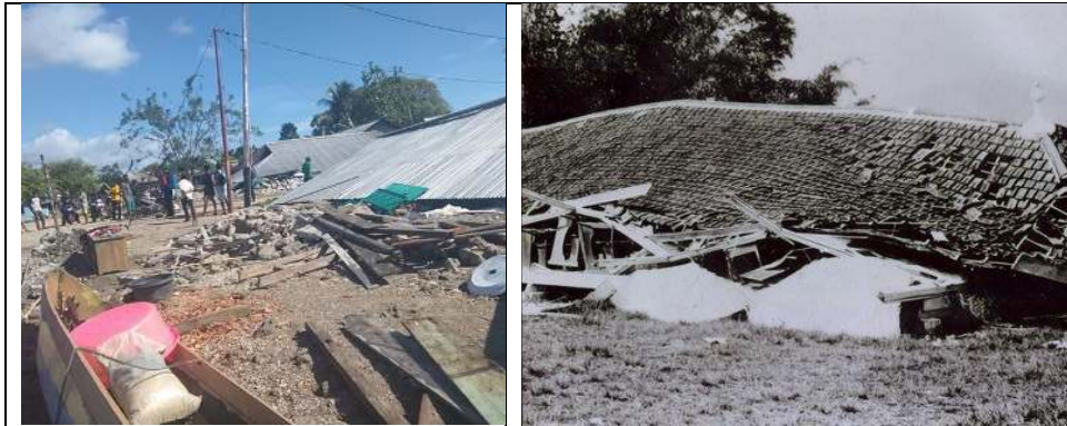
Gempa Halmahera. Atap rumah berbentuk pelana memanjang runtuh kebawah akibat tiang tidak bisa menahan beban gempa bumi
