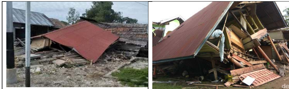
Gambar 03.a: kerusakan pada tumpuan yang menyebabkan kerusakan atap (Gempa Halmahera Selatan)
