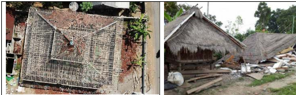
Gambar 08.a: Konstruksi atap dalam situasi relatif utuh turun seluruhnya (Gempa Lombok) Gambar 08.b: Konstruksi bamboo ikut runtuh terkena hempasan gempa bumi, namun atap nya masih utuh
