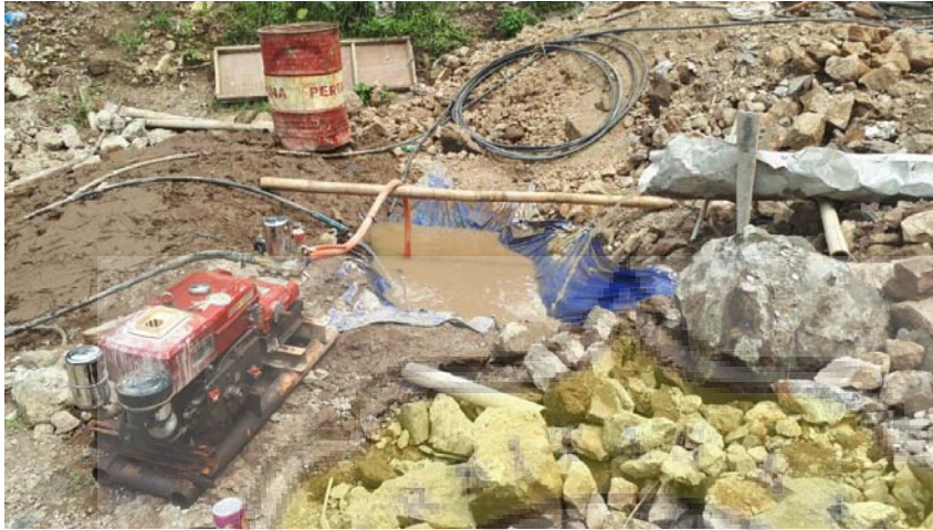
Gambar 3.4. Bak penampungan air soil nailing (Sumber: dokumentasi pribadi, 2017)
