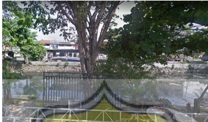
Gambar III.17 Kondisi drainase pada tapak
