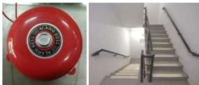
Gambar 5 19 Alarm Kebakaran & Tangga darurat
