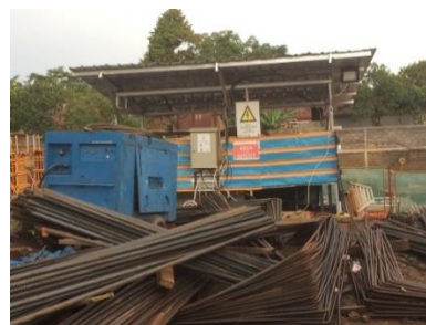
Gambar 3.49 Generator Set Sumber: Dokumentasi Proyek, 2018
