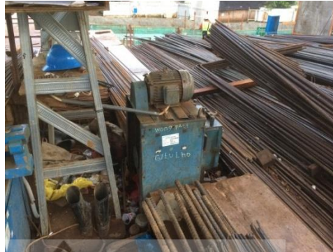
Gambar 3.40 Bar Cutter Sumber: Dokumentasi Proyek, 2018
