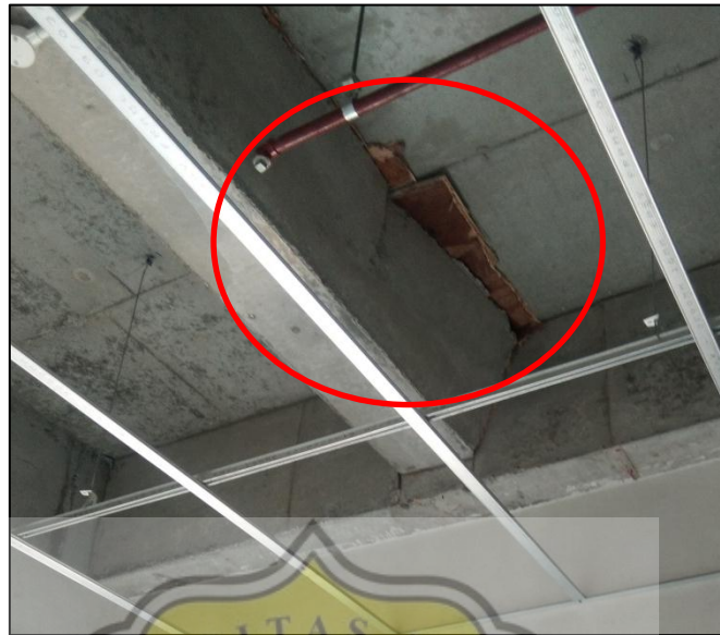
Gambar 3.75 Bekisting Yang Tertinggal
