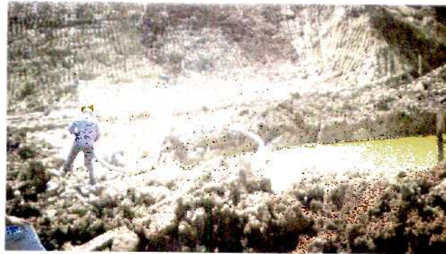
Gambar 3. 40 Genangan Air mengganggu Pekerjaan Bore Pile (Sumber: Dokumentasi Pribadi)
