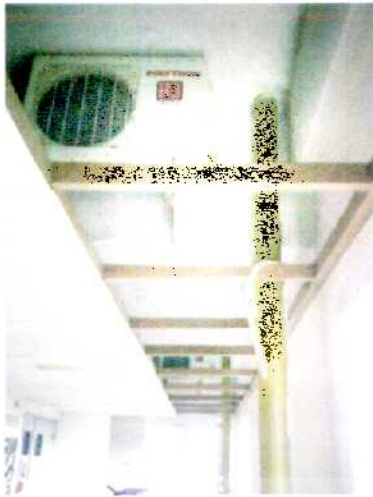
Gambar 56 : Posisi Outdoor AC di Sisi Timur Bangunan
