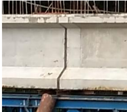
Gambar 3. 18. Celah Balok Girder sebelum di Stressing
