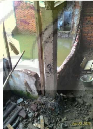
Kondisi Kolom Jadi
